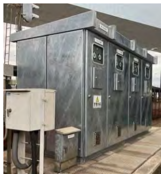
〔昭和島第2配電室更新〕
