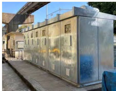
〔昭和島第3配電室更新〕
