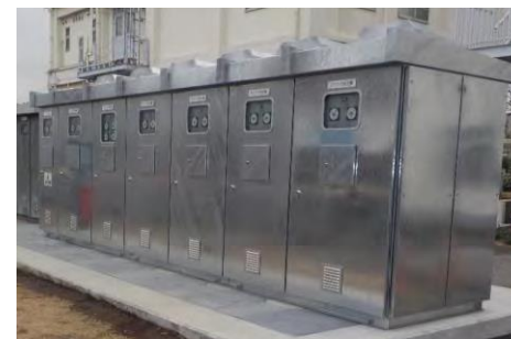
〔昭和島第1配電室更新〕
