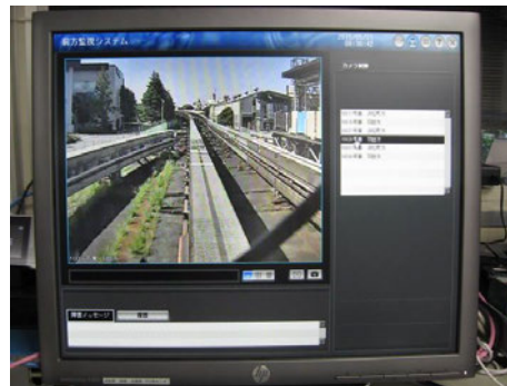
〔地上側モニタ装置〕
