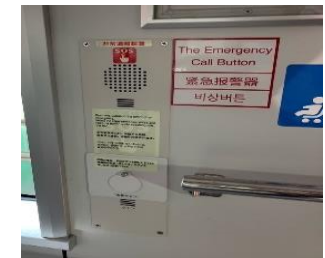
〔非常通報装置〕
