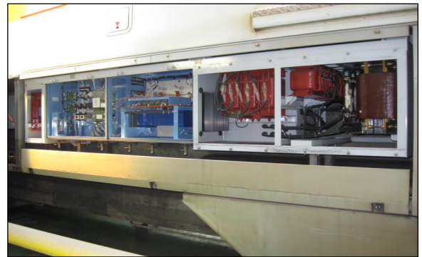
〔補助電源装置〕
