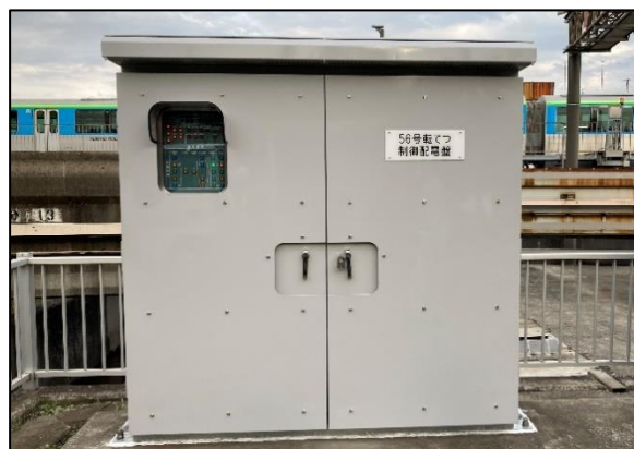
〔車庫内転てつ器制御配電盤更新〕
