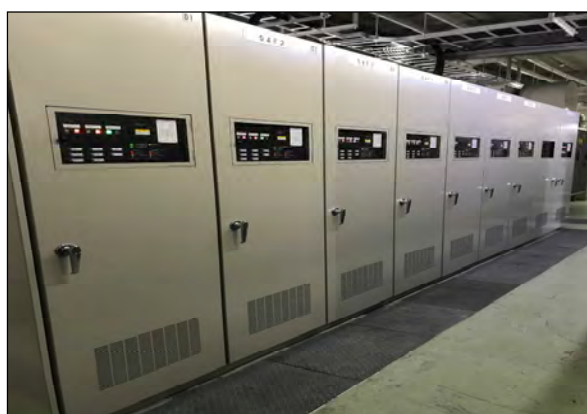
〔直流高速度遮断器更新〕
