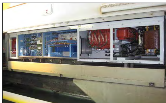
〔補助電源装置〕
