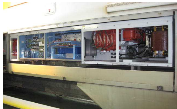
〔補助電源装置〕
