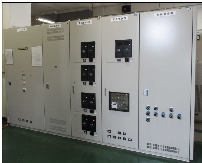
〔変電所制御装置〕
