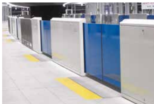
全駅にホームドアを設置しています
