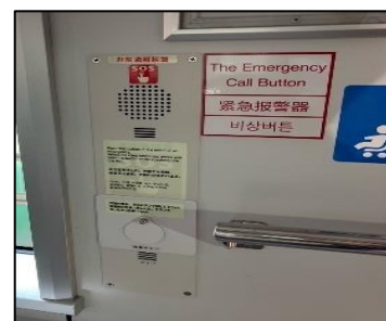
〔非常通報装置〕
