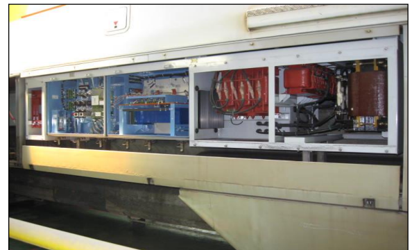
〔補助電源装置〕
