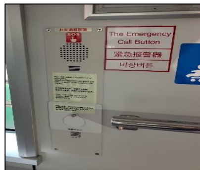
〔非常通報装置〕
