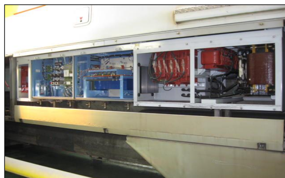
〔補助電源装置〕
