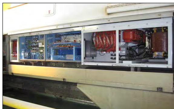
〔補助電源装置〕
