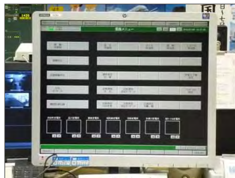
〔電力指令室訓練装置〕
