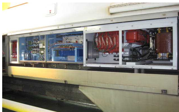
〔補助電源装置〕
